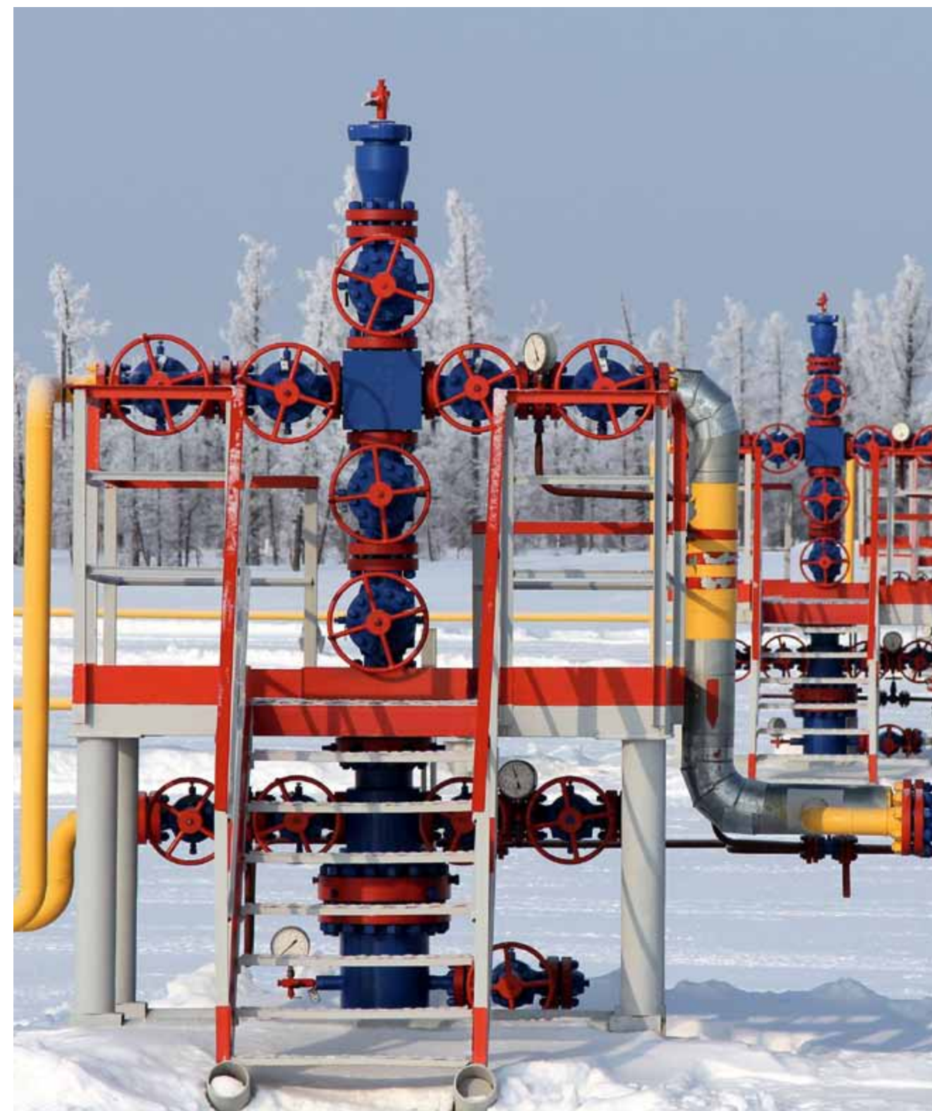
Куст скважин Южно – Русского нефтегазоконденсатного месторождения
