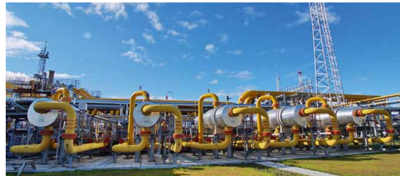
Рекуперативные теплообменники дожимной компрессорной станции Южно-Русского нефтегазоконденсатного месторождения
