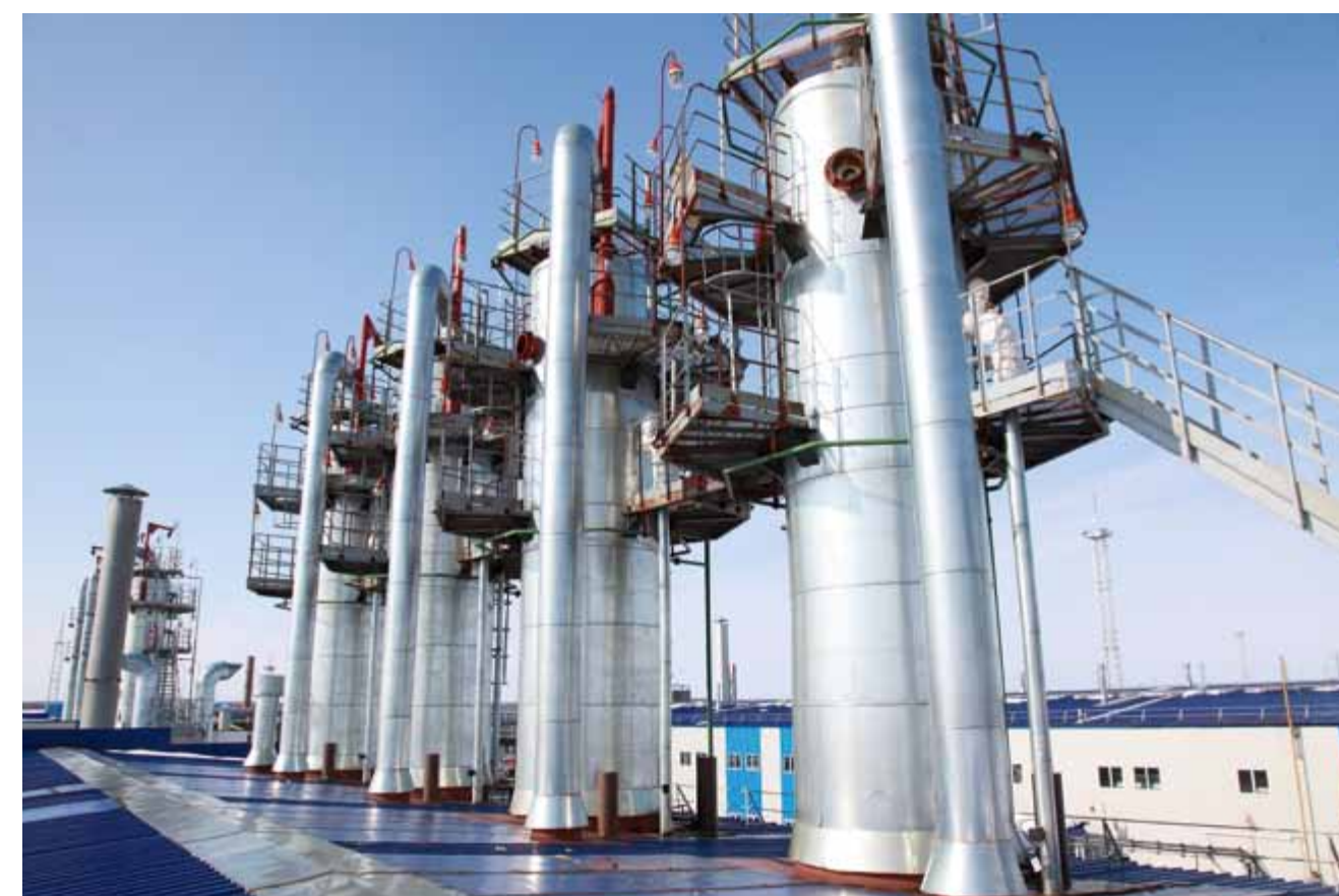
Абсорберы комплекса осушки газа Южно-Русского нефтегазоконденсатного месторождения
