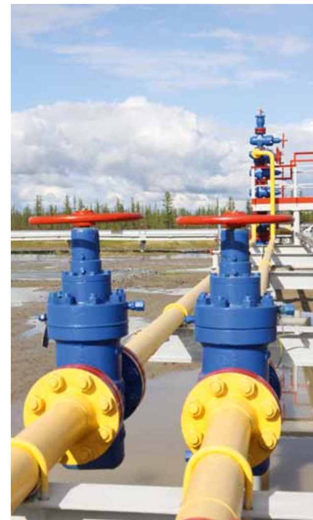
Шлейф газосборной сети Южно-Русского нефтегазоконденсатного месторождения
