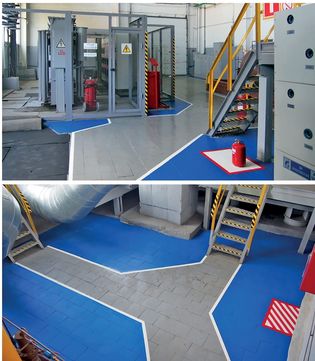
Рисунок Е.1, лист 1 – Примеры организации в производственных зданиях и помещениях вертикальной и горизонтальной разметки
